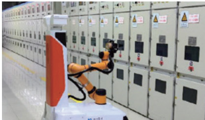
高压配电柜操作
